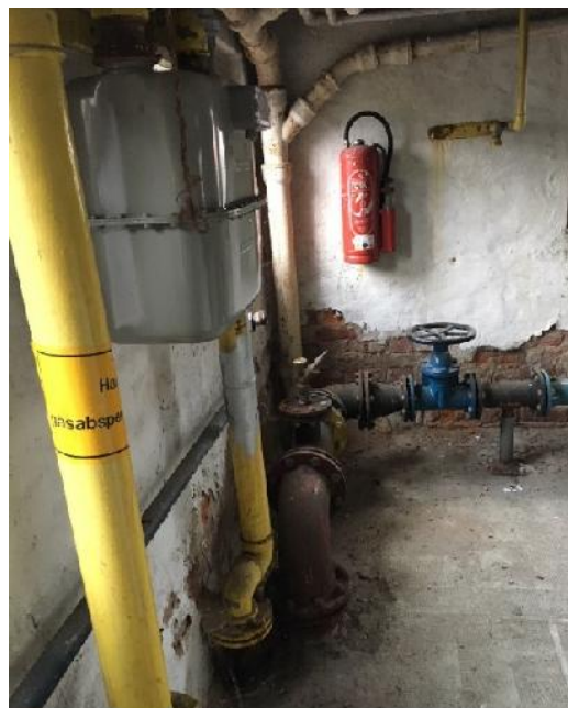
Abb. 40 Versorgungsanschluss Gas für Hauptbahnhof auf ehemaligen Grundstück Aurelis
